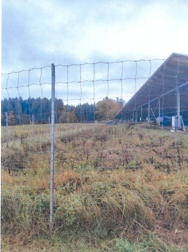
Abbildung A. 3: Blick Richtung Osten am nördlichen Ende der PV-Anlage
